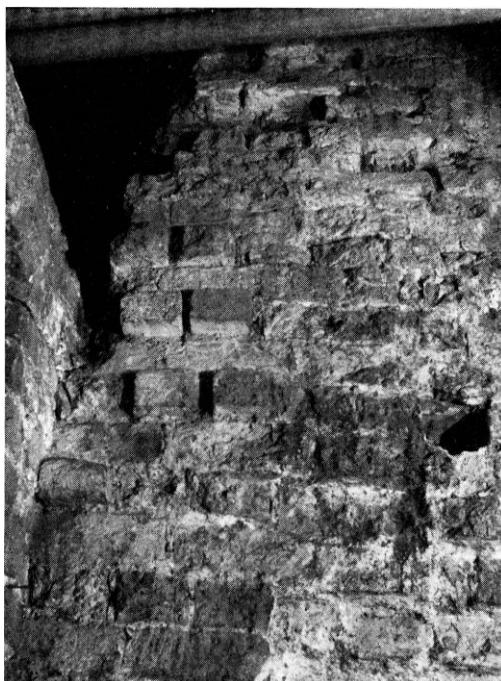
Fig. 182. Udsnit af sydsiden af den søndre pille med ubenyttet fortanding til vesttårn (p. 198). — Section of south side of the south pier with unused toothings to the west tower.
