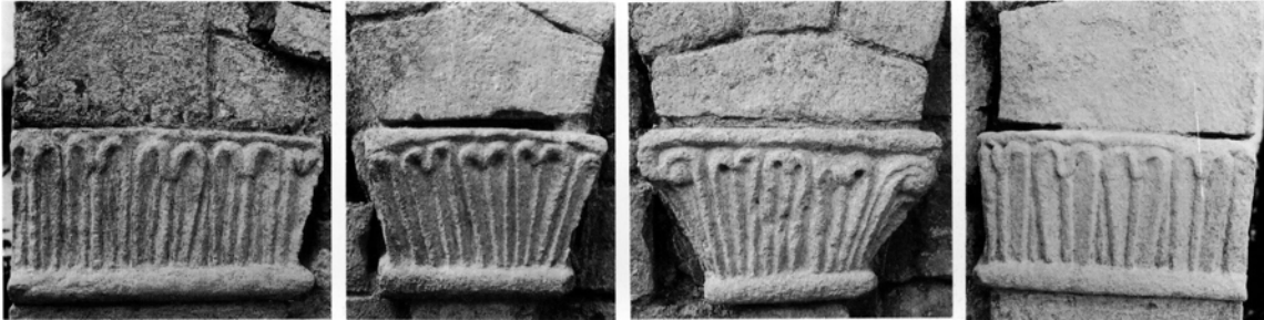
Fig. 7. Kapitælerne på korets gavl (s. 3074). Erik Skov og Morten Aaman Sørensen fot. 1972. - The capitals on the gable of the chancel (cf fig. 4).
