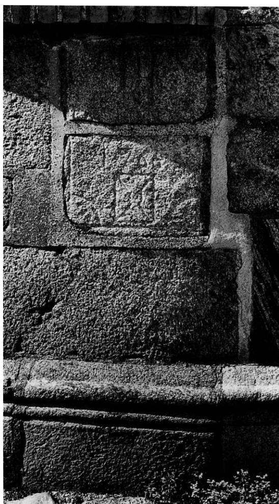
Fig. 9. Udsnit af apsidens facade med indmurede gravstensstykker (s. 4728) og profileret sokkel (s. 4704). KdeFL fot. 1997. - Section of the facade of the apse where fragments of tombstones (p. 4728) are included.
