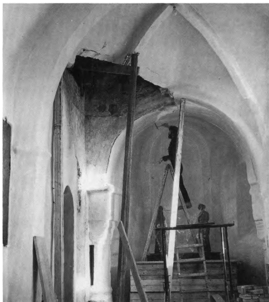
Fig. 15. Koret set fra vest, efter hvælvs delvise sammenstyrtnings (s. 2486). Henrik Græbe fot. 1971. - Chancel seen from the west after the partial collapse of the vault.
