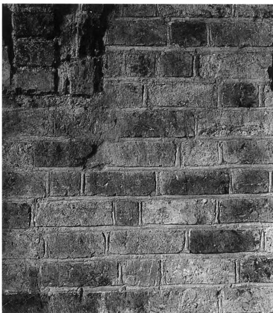
Fig. 60. Oprindelig fugning på ydersiden af østre korsarm, set fra sakristiet (s. 3070). Mogens Clemmensen fot. 1917-21. - Original pointing on the exterior of the east transept, seen from the sacristy.
