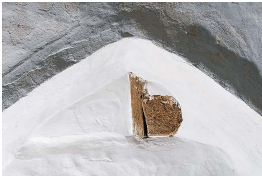
Fig. 22. Overskåret bindbjælke med spærstiver i vestforlængelsens sydmur (s. 2116 ff.). Foto Arnold Mikkelsen 2008. – Severed tie-beam with rafter-support post in the south wall of the western extension.
