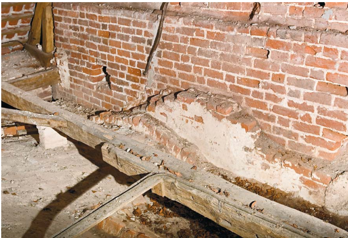
Fig. 24. Ubenyttet hvælvforlæg på indersiden af søndre korsarms gavl, set fra nordvest i loftsrummet (s. 2119). Foto Arnold Mikkelsen 2009. – Unused preparation for vaulting on the inner side of the gable of the south transept, seen from the north-west loft area.
