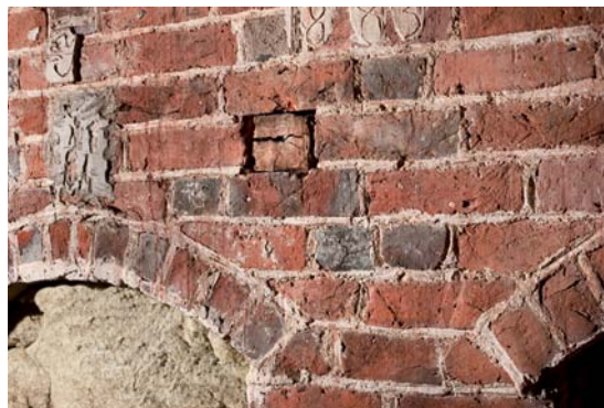
Fig. 44. Galleriåbninger og bomhul med overhugget ende fra stilladsbjælke på nordre højkirkemur, set fra nordvest fra nordre sideskibs loft (s. 2262). Foto Arnold Mikkelsen 2009. – Gallery and putlock hole with severed end of a scaffolding beam on the north clerestory wall, seen from the northwest, from the loft of the north aisle.
