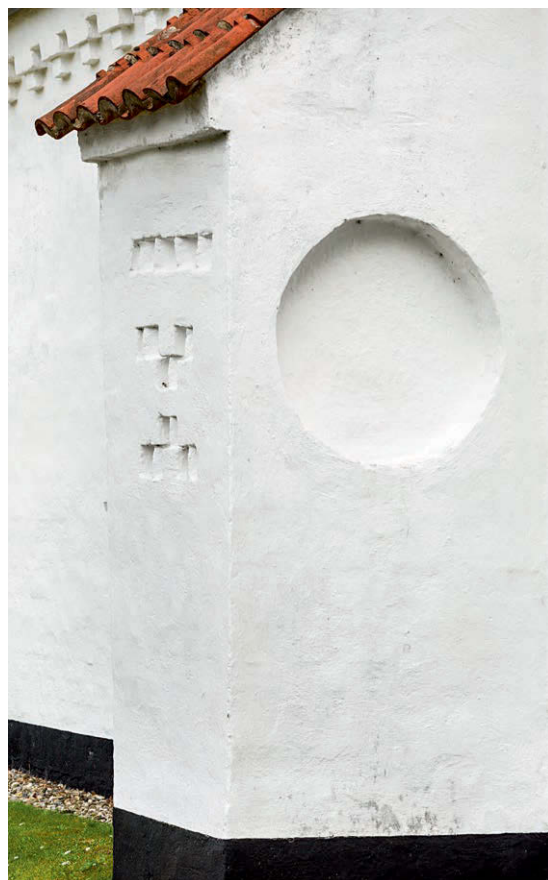
Fig. 11. Støttestille på skibets nordside (s. 4276). Foto Arnold Mikkelsen 2016. – Buttress on the north side of the nave.
