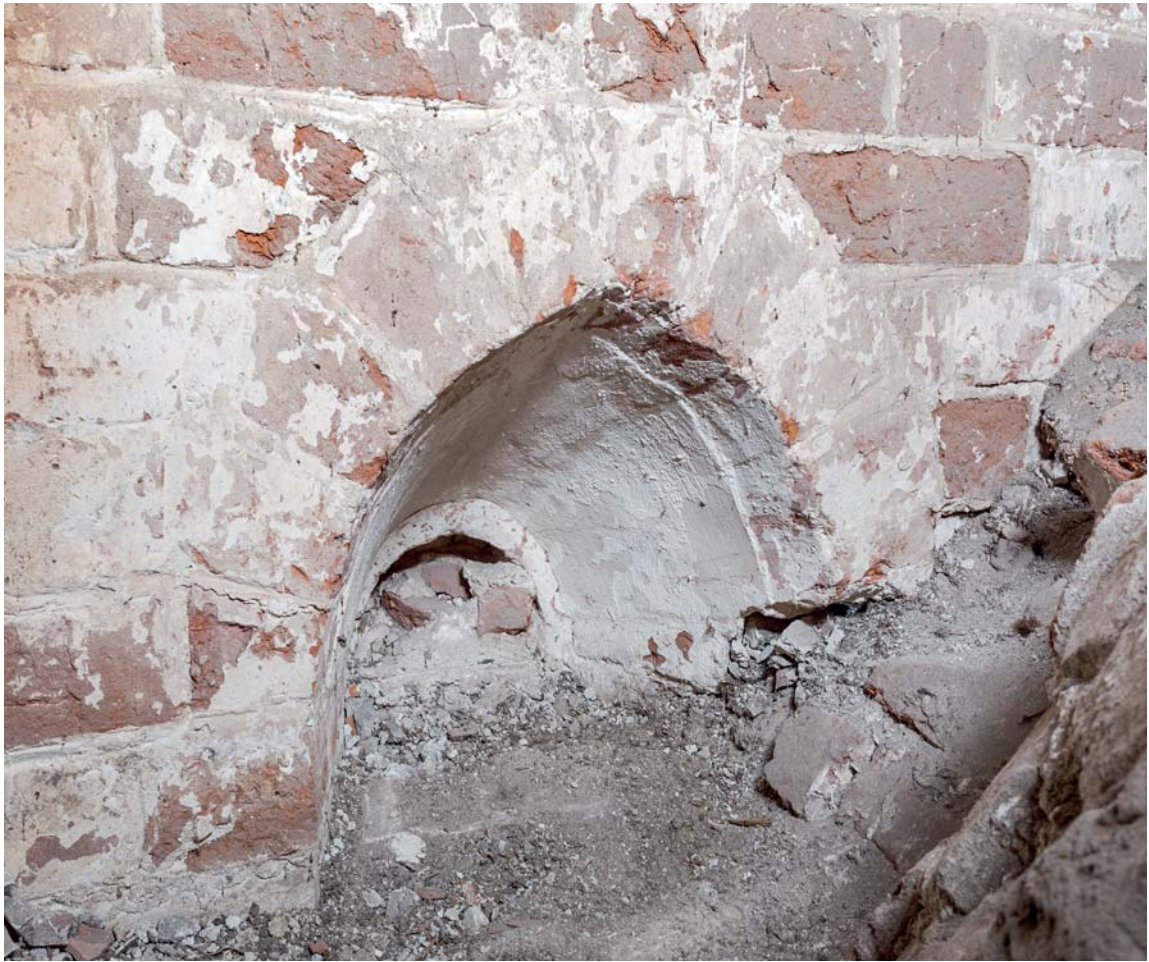
Fig. 7. (†)Vindue i det unggotiske skibs nordside (s. 4525), set fra tagrummet. Foto Arnold Mikkelsen 2017. – (†)Window in north side of Early Gothic nave, seen from the loft.
