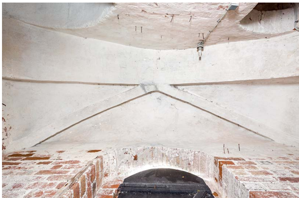
Fig. 13. Sakristiets indre, detalje med hvælv og vindue (s. 4528). Foto Arnold Mikkelsen 2017. – Interior of sacristy, detail with vault and window.
