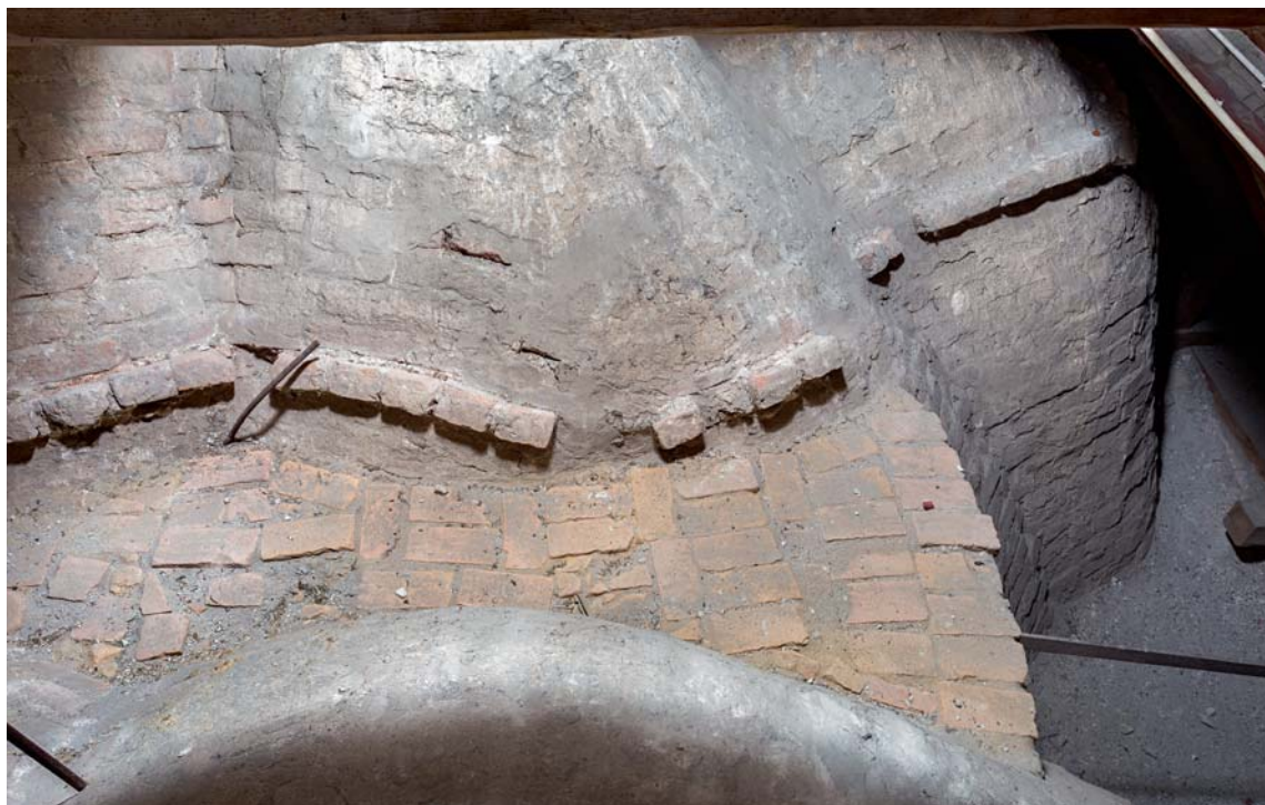
Fig. 32. Forstærkning fra 1821 (s. 4602) samt langhuskorets østre hvælv med overribber (s. 4595). Foto Arnold Mikkelsen 2017. – Reinforcement from 1821 and eastern bay of nave-chancel with upper ribs.
