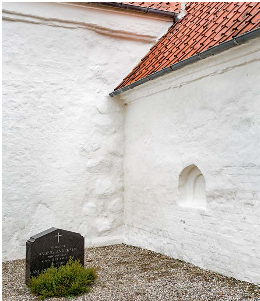
Fig. 25. (†)Vindue (s. 4597) i våbenhusets vestre flankemur. Foto Arnold Mikkelsen 2017. – (†)Window in the western flanking wall of the porch.
