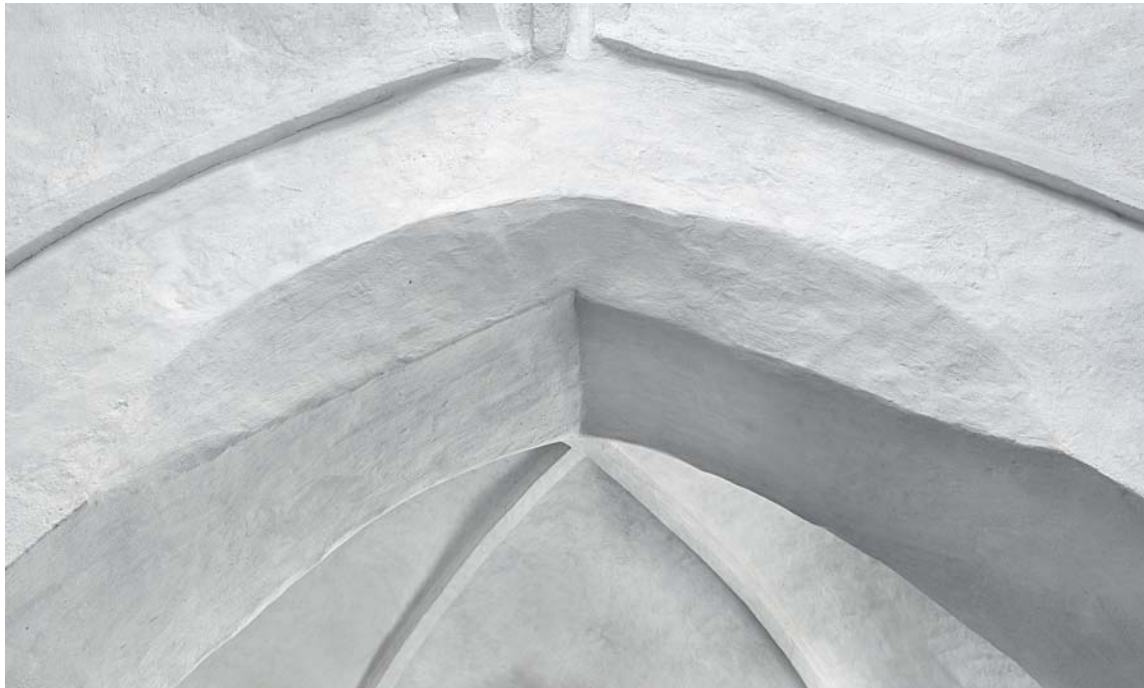
Fig. 72. Hugget spor i korbuen for \dagger lektorieprædikestol? (s. 4742 og 4771). Foto Arnold Mikkelsen 2017. – Cut traces in the chancel arch for \dagger lectorium pulpit?
