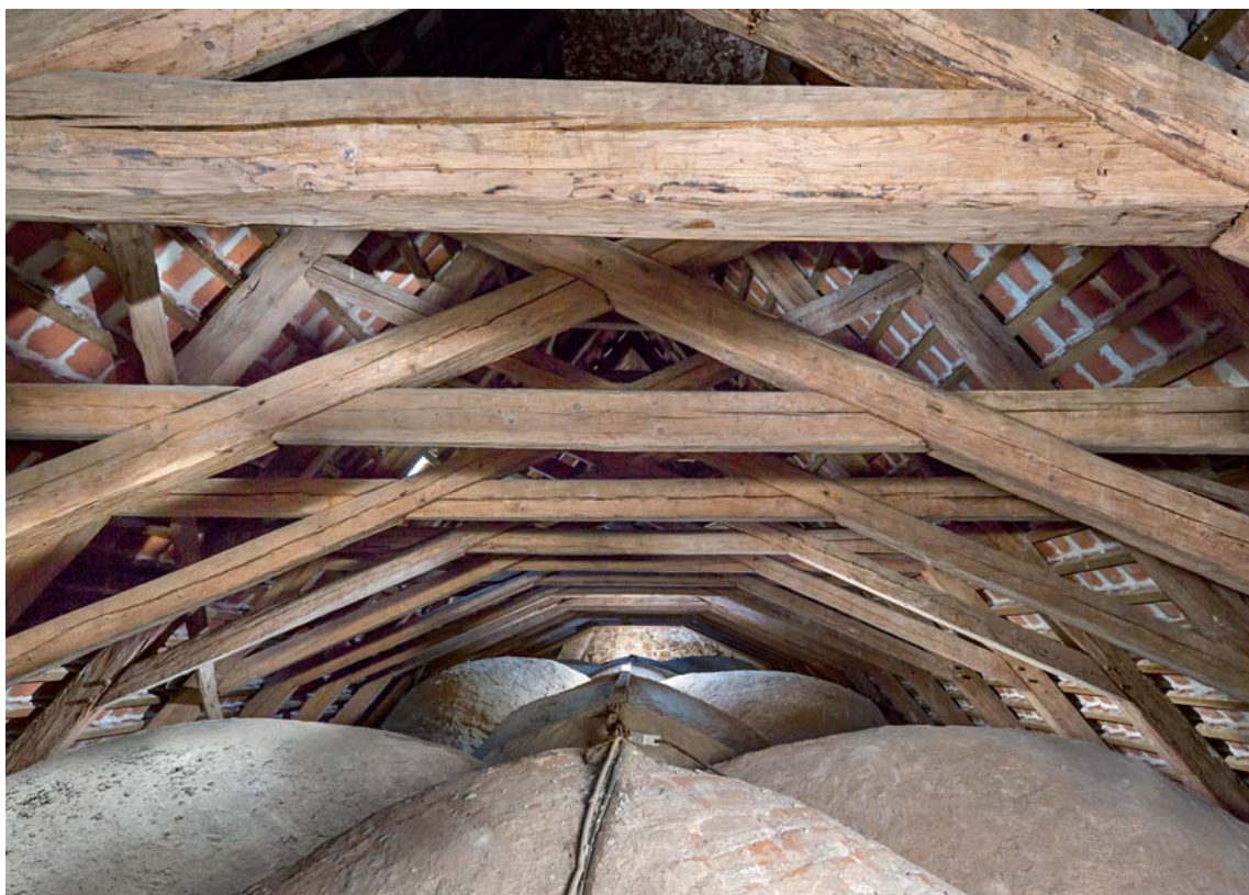
Fig. 17. Oversiden af skibets hvælv (s. 5038) set mod øst. Foto Arnold Mikkelsen 2018. – The nave vault looking east.
