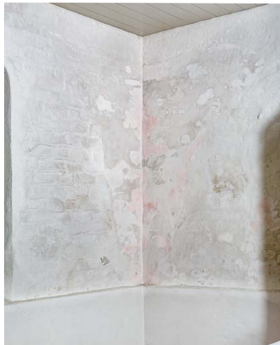
Fig. 10. Spor efter hvælv i koret (s. 5178), set mod nordøst. Foto Arnold Mikkelsen 2018. – Remains of the chancel vault looking north east
