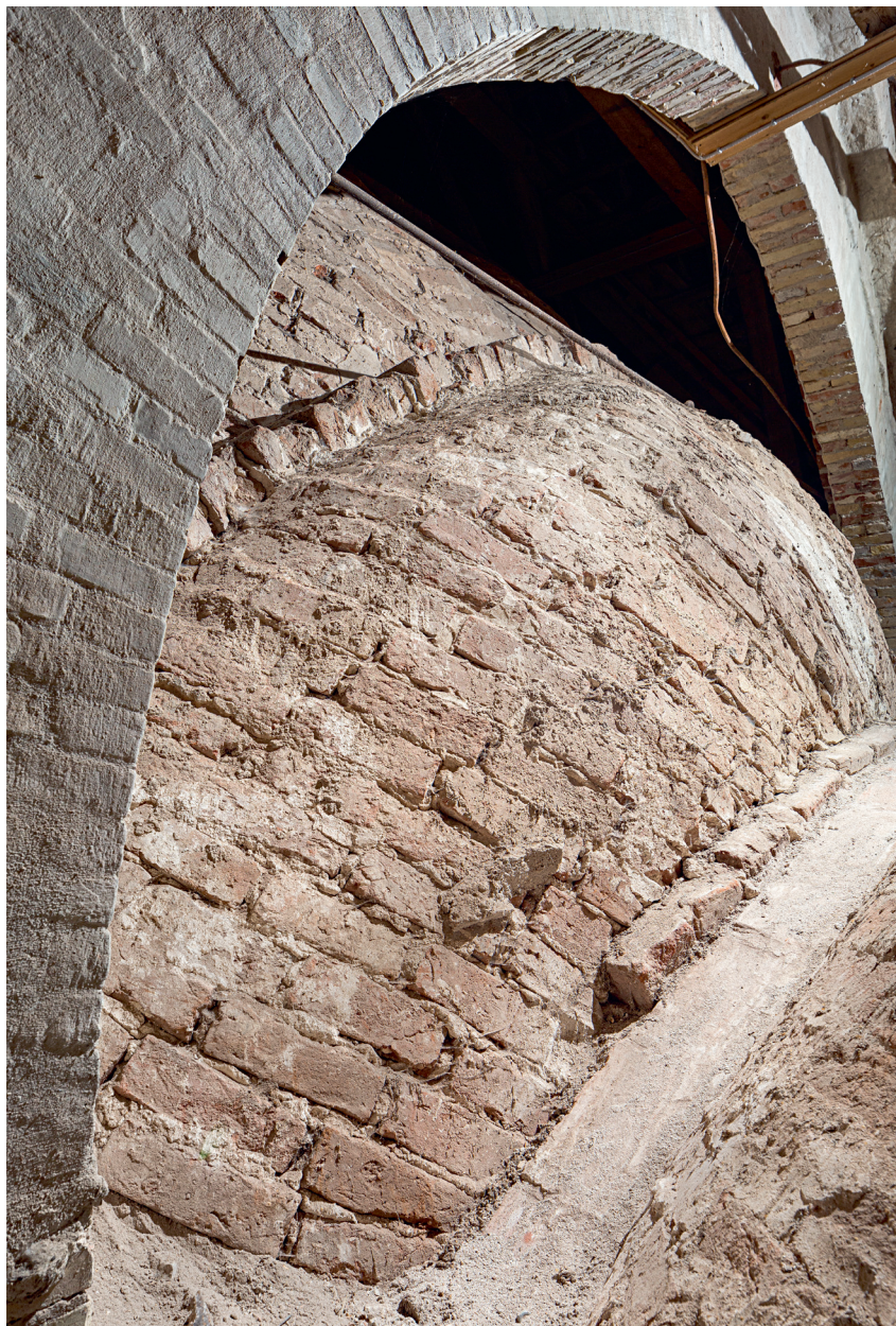
Fig. 17. Overgang mellem korets og skibets hvælv (s. 5517) med sekundær spidsbuestik, der bærer skibets østgavl (s. 5526). Set fra koret, fra sydøst, Foto Arnold Mikkelsen 2019. – Transition between vaults of nave and chancel with secondary relieving arch bearing the east gable of the nave. Seen from the chancel, from the south east.
