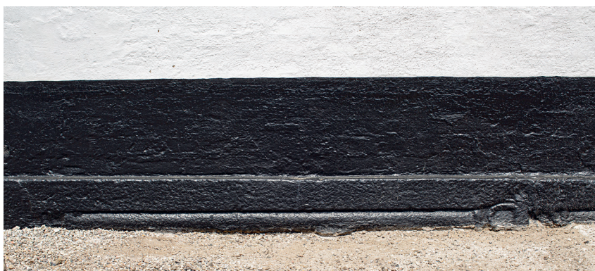
Fig. 8. Romansk karmsten af granit (s. 5776), genanvendt som sokkel under våbenhusets sydmur. Foto Arnold Mikkelsen 2020. – Romanesque jamb of granite, now in the south wall of the porch.
