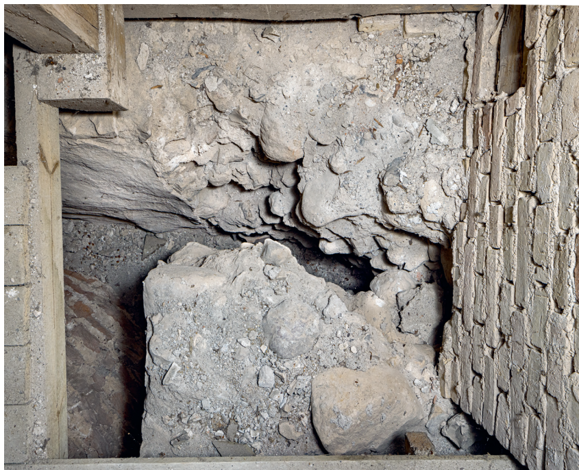
Fig. 115. Revne mellem skibets nordmur og triumfmuren (s. 6565). Foto Arnold Mikkelsen 2022. – Gap between the north wall of the nave and the chancel arch wall.
