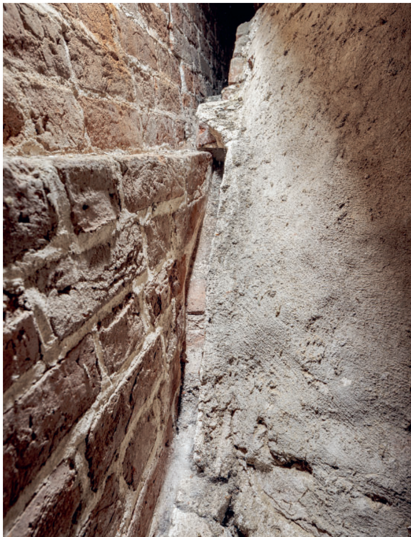
Fig. 86. Udskridning af korgavl med sprække mellem gavlen og korets hvælv (s. 6650). Foto Arnold Mikkelsen 2024. – Protrusion of the chancel gable with gap between the gable and the chancel vault.
