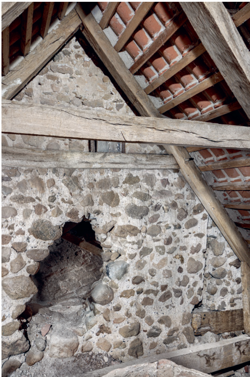
Fig. 41. Triumfgavlens østside med gennembrudt hul (s. 6841, jf. fig. 42). Foto Arnold Mikkelsen 2024. – East side of the chancel arch gable with a hole broken through.
