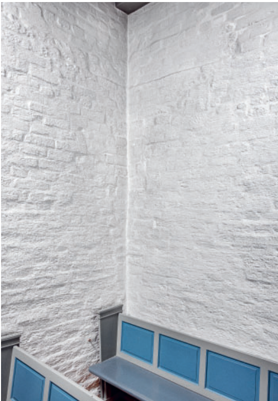
Fig. 21. Hvælvforlæg i vestforlængelsens sydvestlige hjørne (s. 6926). Foto Arnold Mikkelsen 2024. – Traces of an unfinished vault in the western extension's south west corner.
