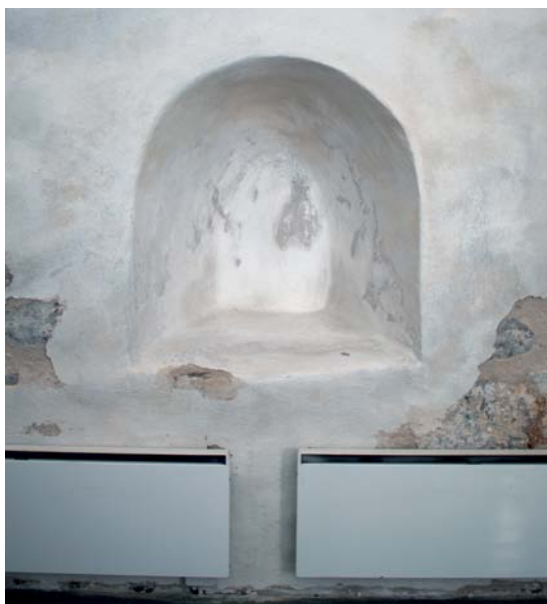
Fig. 56. Blændet 'spedalskhedsvindue' i korets sydvæg (s. 1486). Foto Hugo Johannsen 2010. – Verblendetes 'Leprafenster' in der Südwand des Chores .
