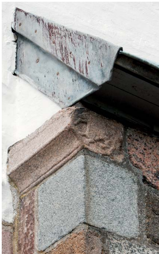
Fig. 10. Detalje af skibets sydvestre hjørne med genanbragt kragsten fra †korbue (s. 1638). Foto Hugo Johannsen 2012. – Detail der südwestlichen Ecke des Schiffes mit wiederangebrachtem Kämpfergesims aus †Chorbogen.
