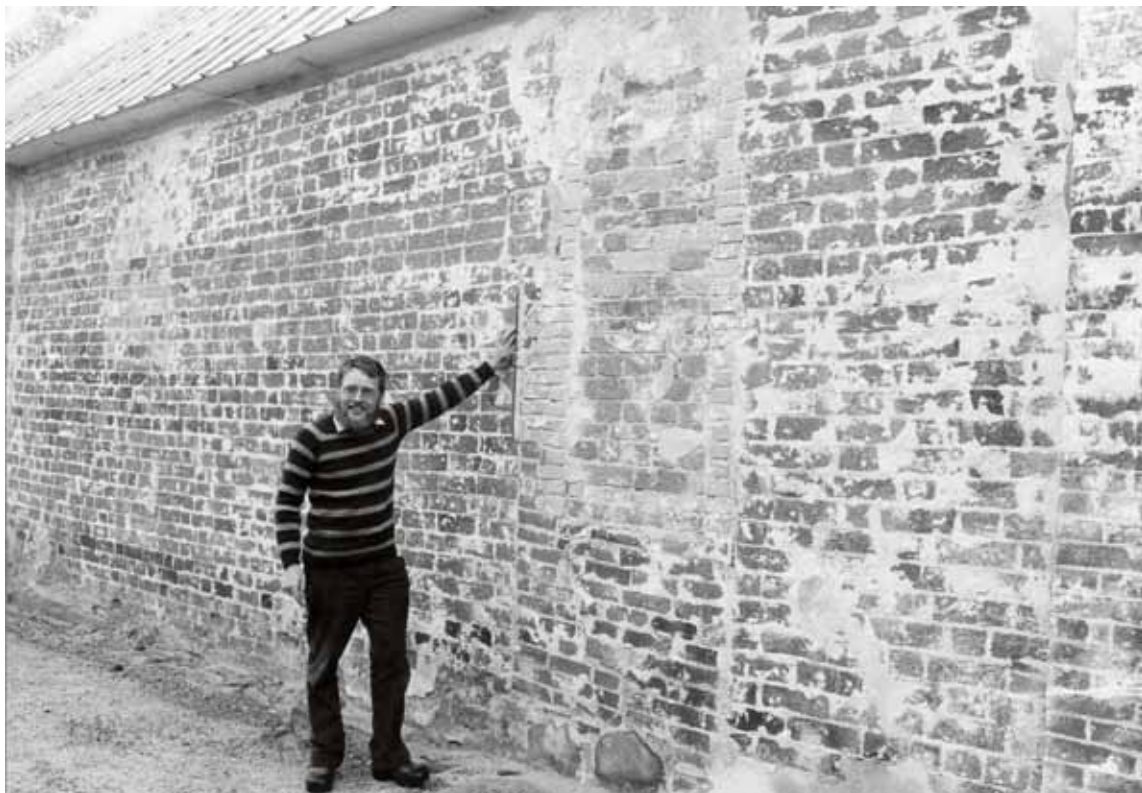
Fig. 10. Kirkens nordmur afrenset (s. 2451) set fra nordvest. I forgrunden sognepræst Niels Henrik Arendt, senere biskop i Haderslev. Foto i Holstebro Museum o. 1980. – North wall of church cleaned seen from the north west.
