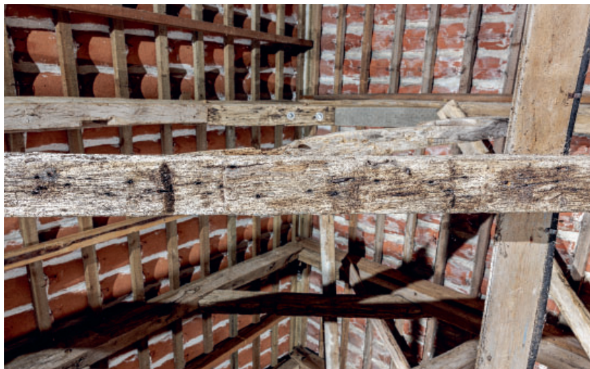
Fig. 25. Spor efter ældre tagbeklædning på undersiden af langhusets hanebånd (s. 4217). Foto Arnold Mikkelsen 2024. – Traces of an older roof on the bottom of the nave's collar beam.
