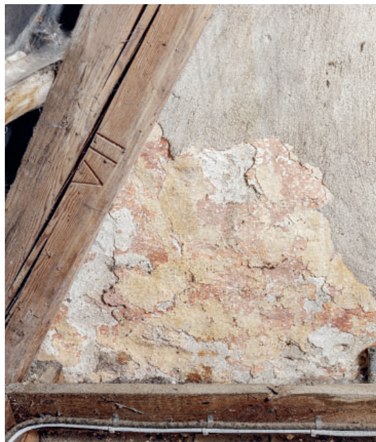
Fig. 15. Farvede kalklag på skibets nordfacade set fra våbenhusets loft (s. 4373). Foto Arnold Mikkelsen 2024. – Layers of coloured lime on the nave's north facade seen from the loft of the porch.
