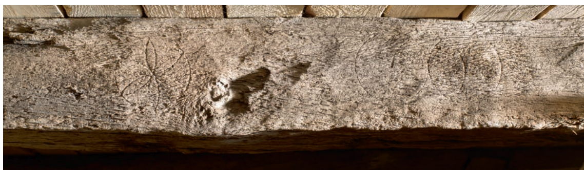
Fig. 16. Graffiti på spær i korets nordside set fra øst (s. 2501). Foto Arnold Mikkelsen 2016. – Graffiti on rafter in north side of chancel, seen from the east.
