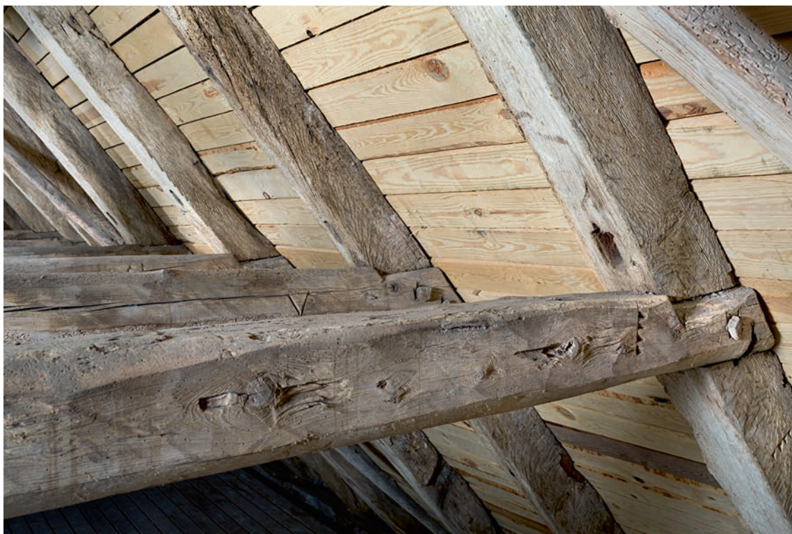
Fig. 14. Taphul til skråstiver i sydspær i skibet samt spærnumre, set fra vestnordvest (s. 2501). Foto Arnold Mikkelsen 2016. – Mortise hole for strut in south rafter of nave, and rafter numbers, seen from west-north-west.
