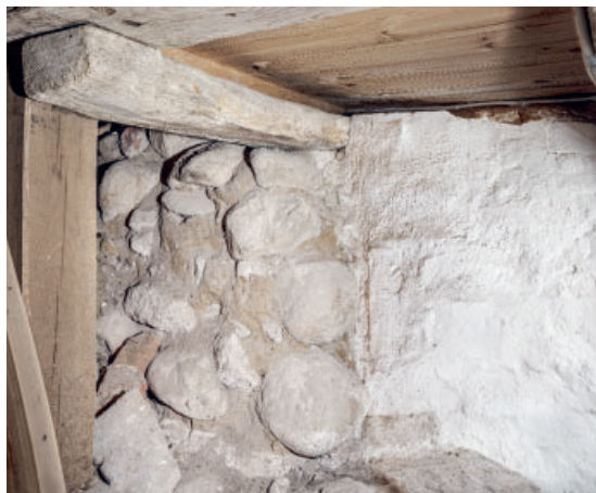
Fig. 18. Rest af skibets vestgavl set mod nord (s. 4106 og 4110). Foto Arnold Mikkelsen 2023. – Remains of the nave's western gable wall looking north.
